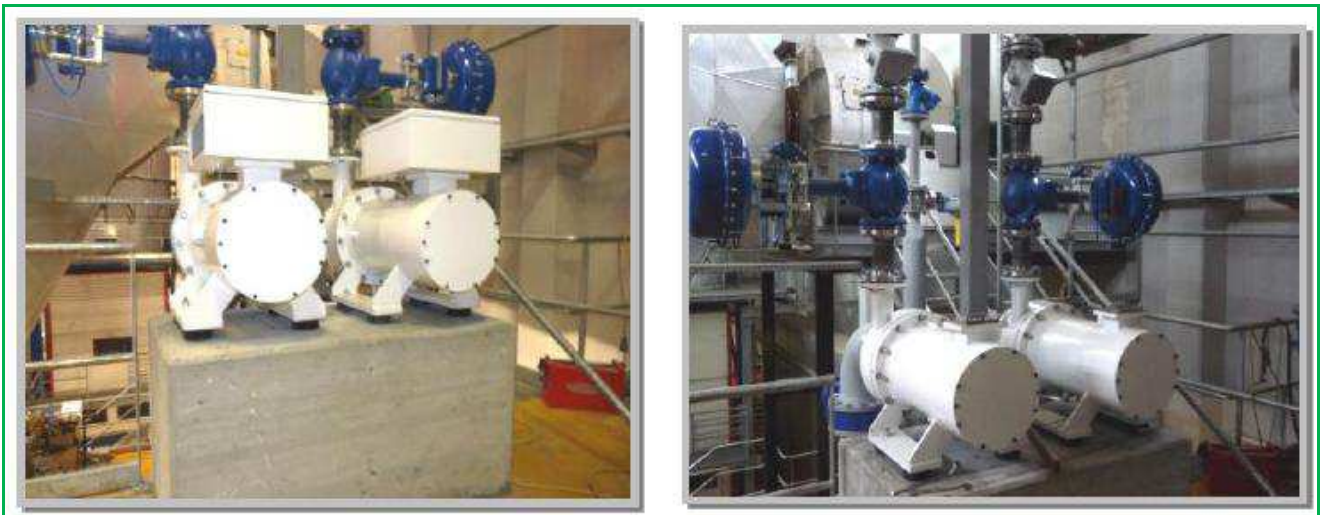
Figura 1. Esempio di Installazione di 2 turbine ORC di potenza complessiva 300 kW
